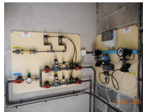
Équipement chloration, Réservoir d'Eau Potable de la Folte / Cérilly
