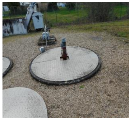
Motoréducteur neuf à la Station d'Épuration de Cérilly
