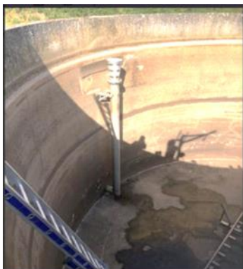
En blanc, tuyau décanteur digesteur de 5m, station d'épuration de Cérilly
